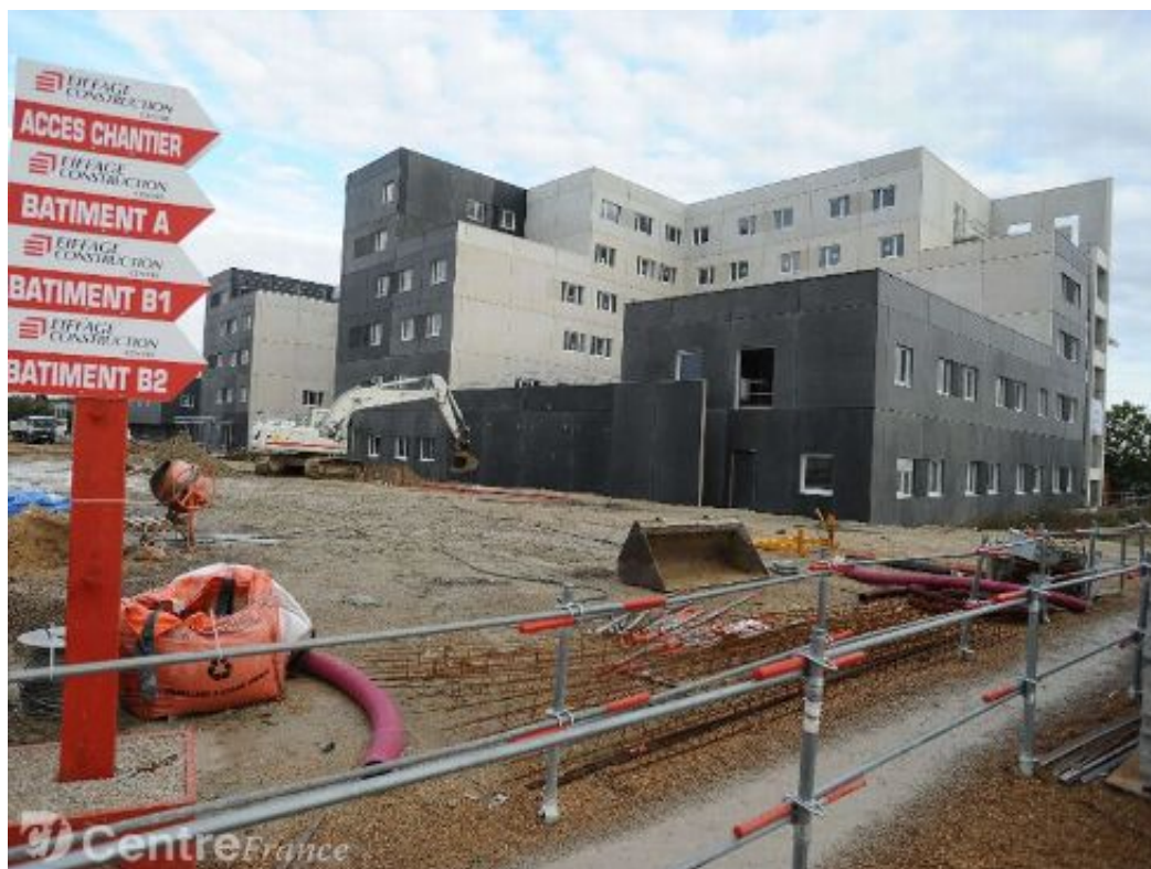
Le pôle santé Oréliance sera opérationnel d'ici la fin du mois d'août.? - Photo Frank le roux
